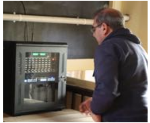
Tony sets up the controls for the AV system
